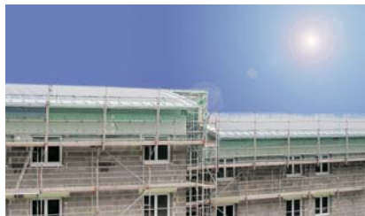
Blick auf die Photovoltaikdächer der Gebäude Petrisberg 7 + 8
